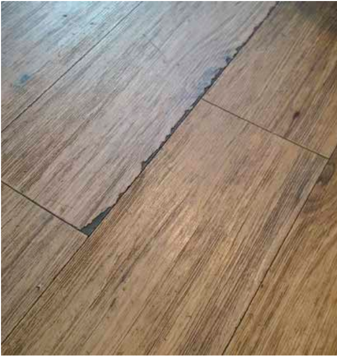
Abplatzungen bei mehrschichtigen Design-Bodenbelägen: Jetzt hilft nur noch ein Austausch.
